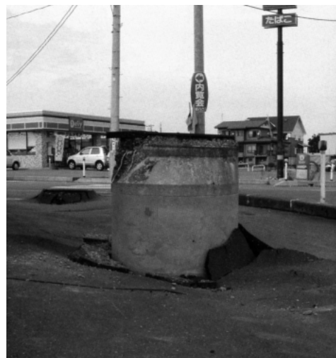
写真-2 マンホールの浮き上がり 3)
