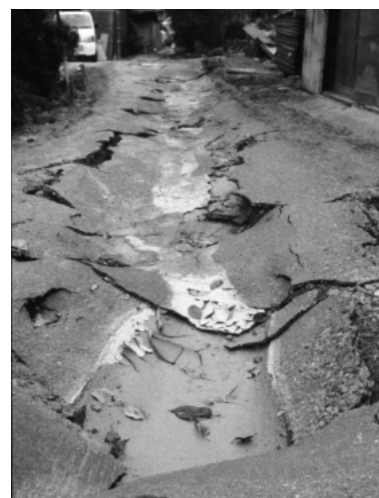
写真-3 管渠埋め戻し部の陥没 3)
